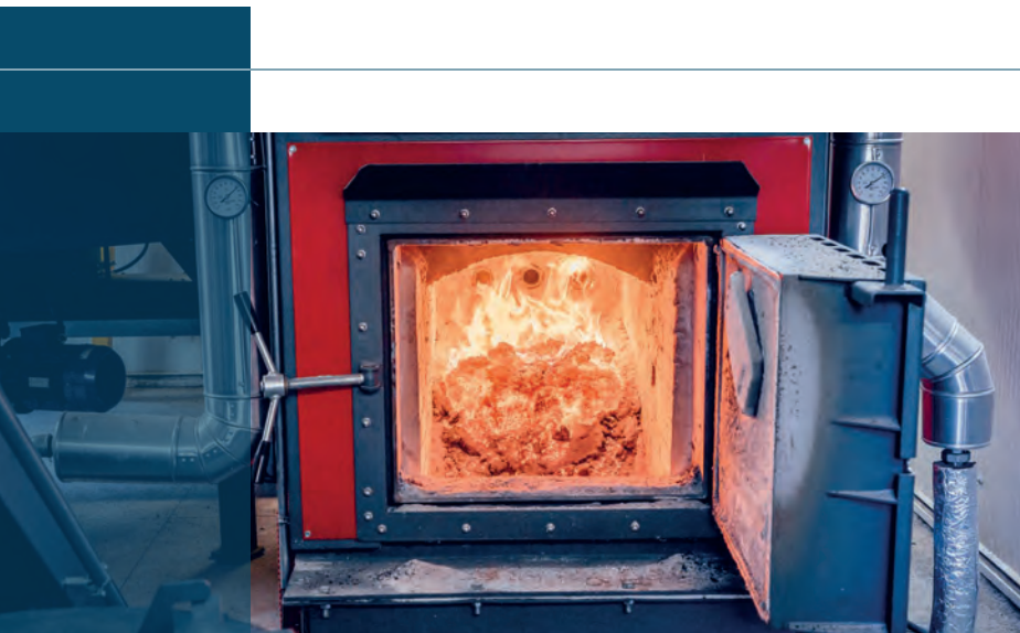
Caldia a biomassa, Azienda Agricola Valier (RO)
